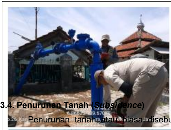
Foto 2. Sumur Perumda Tirtayasa (PDAM Kota Pekalongan) yang berlokasi di Kadang Panjang, Pekalongan Utara.
