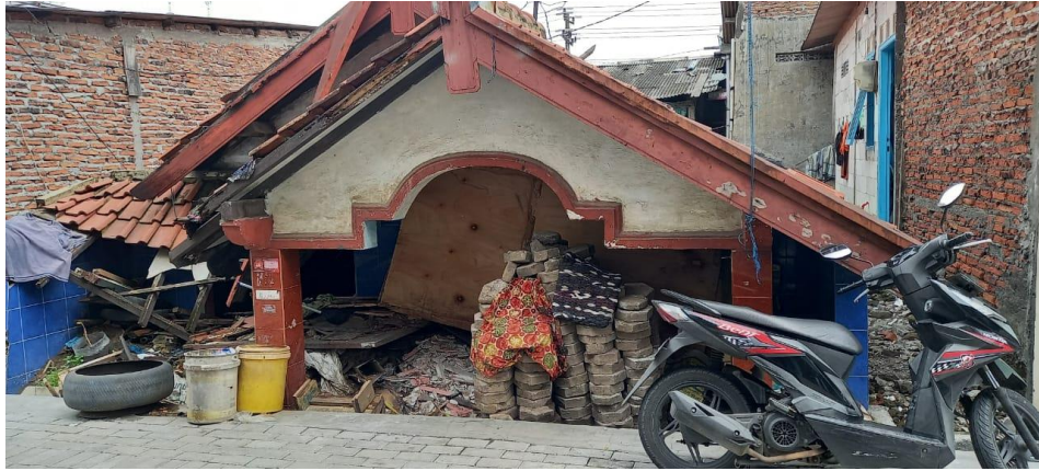
Rumah yang mengalami penurunan tanah di Desa Tambak Rejo, Kec. Genur, Kota Semarang (penurunan sekitar 2 meter)
